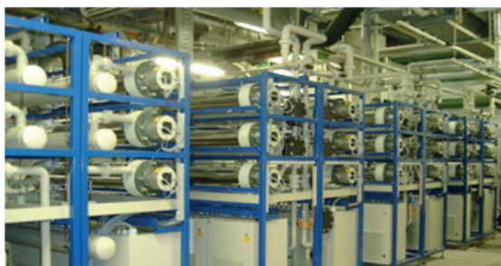
Système AOP pour le traitement de la DCO dans les eaux de rejets chez BASF en Allemagne
